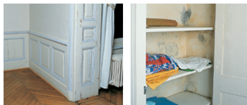
La peinture des boiseries qui cloque
